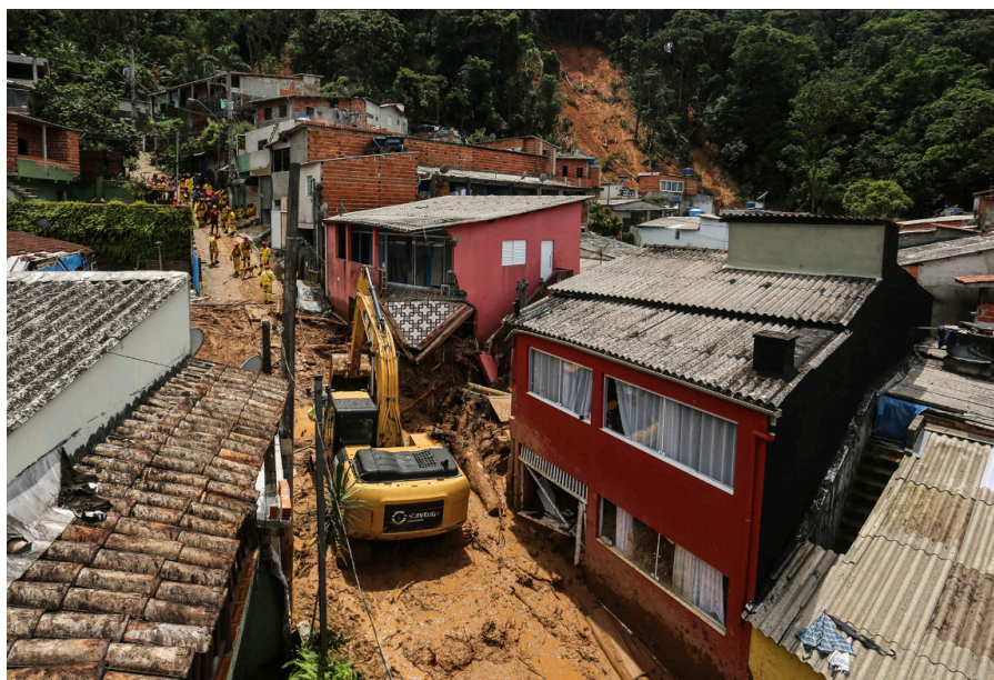
Imagem 6: Imagens registradas durante a tragédia causada pelas fortes chuvas e deslizamentos de terra que atingiram a cidade de São Sebastião, na Vila do Sahy. Foto: Fábio Vieira.
