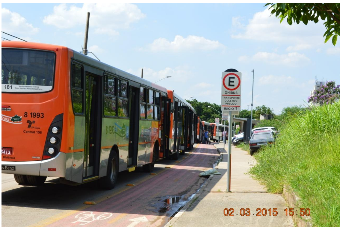
Vista da ciclofaixa/ciclovia da Av. Escola Politécnica, altura do nº 5.165, com pintura apagada, com empçoamento de água e ao lado do ponto final de ônibus.
