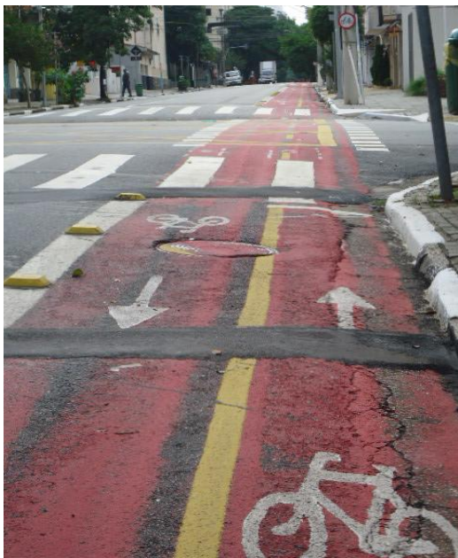
Vista da ciclofaixa da R. Artur de Azevedo, esquina com a Av. Pedroso de Moraes, com tampão de PV e com remendos formando depressão na pista.
