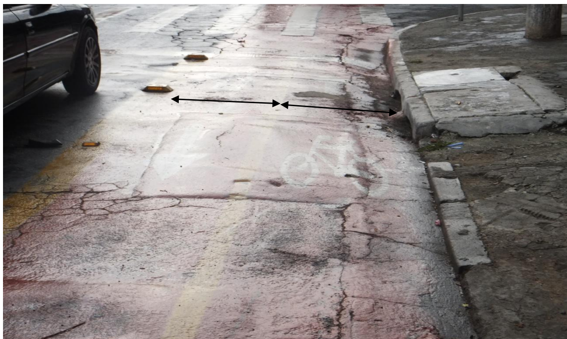
Vista da ciclofaixa da R. Ascenso Fernandes, proximidade da Av. Oliveira Freire, com sarjeta sendo considerada com faixa ciclável e com superfície irregular.
