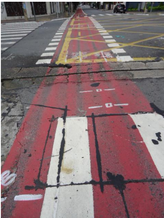
Vista da ciclofaixa da R. Artur de Azevedo, na travessia da Av. Pedroso de Moraes, com trincas e buracos na sarjeta.
